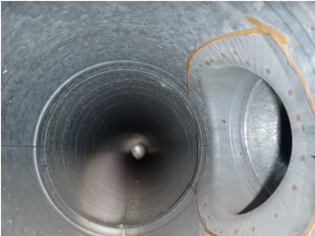
Kuva 13. Tuloilmakanavassa oli hieman pölykertymää....
