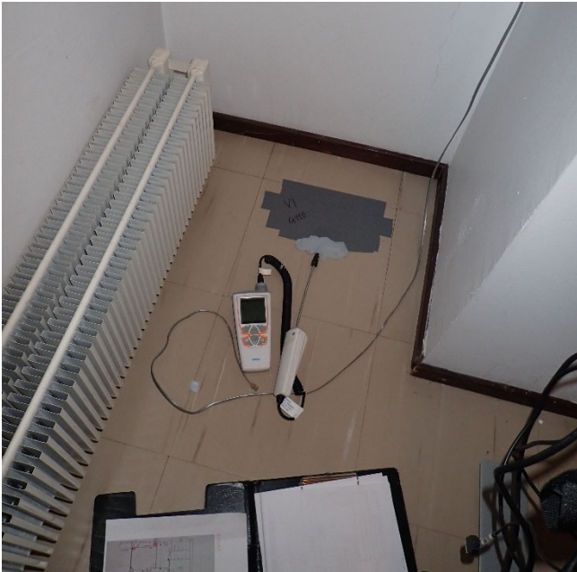
Kuva 5. Viiltomittaus tilassa 101 kosteuspoikkeama-alueelle, joka sijaitsee ns. ulosvedetyn osan nurkassa. Yläreunassa näkyvästä seinästä otettiin materiaalinäyte M5, jossa ei todettu mikrobikasvua.
