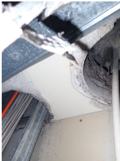
Kuva 18. Koteloinnin takana kulki mm. sähkökaapeloiteja ja läpiviennit ainakin 2. kerroksen välipohjaan olivat tiivistämättömiä, osin tilkitty mineraalivillalla.
