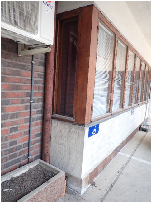
Kuva 2. Toimistohuoneen 101 lattian kosteuspoikkeama-alue on ns. ulosvedetyssä osassa sisäpihan puolella. Lattian taso on lähellä pihan tasoa.
