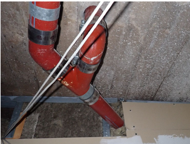
Kuva 20. Kuntosalin (tila 106) akustolevyillä toteutetun lakaton yläpuolella näkyi, kuinka käytävän ja tilan välisen kevyen väliseinän levytys päättyy ennen välipohjaa ja villapinnat ovat näkyvissä. Yläkerrasta tulevat viemärläpiviennit ovat tiivistämättä alapintaan.
