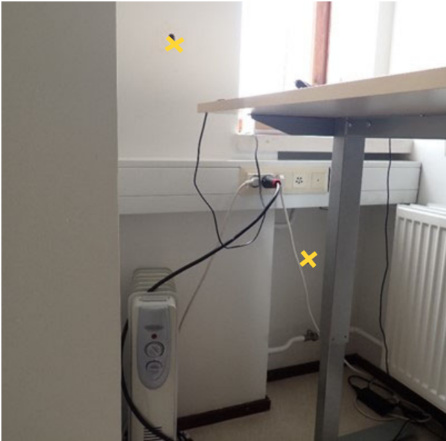
Kuva 7. Rakennusavaukset tilassa 109 tehtiin patterisyvennykseen (R1) sekä seinän umpiossa ikkunan vierelle (R2), sillä patteriputket menevät seinän sisälle, eikä niiden sijaintia seinän sisässä pystytty varmistamaan. Patterisyvennyksessä oli lämmöneristeenä 15 mm puukuitulevy (M1) muualla vastaavilla kohdin havaitun korkin sijaan.
