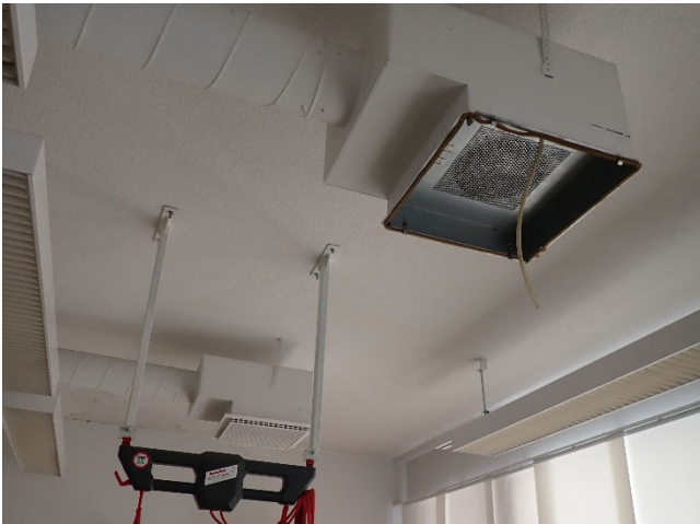
Kuva 11. Tuloilmajärjestelmän päätelaitteet tarkasteltiin avaamalla uloin ritilä (kuvassa taaempi ritilä on paikoillaan). Kuvassa on tilan 109 päätelaite.
