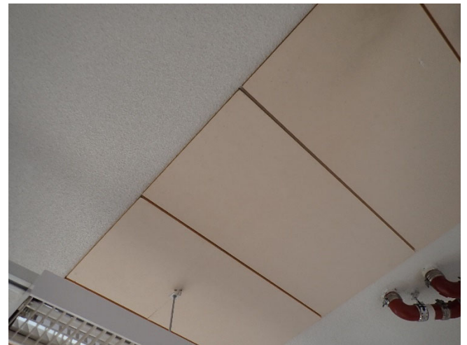
Kuva 21. Osassa tiloista oli alakattojen sijaan kattoon liimatut akustolevyt. Levyt olivat reunoiltaan pinnoittamattomia.
