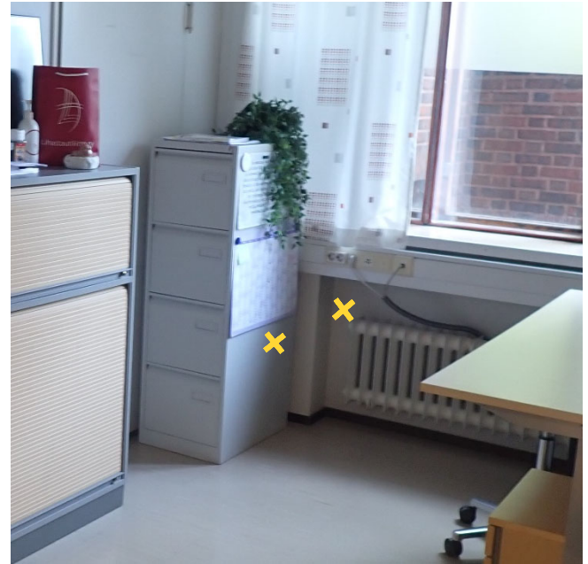
Kuva 8. Toimistohuoneeseen 113 tehtiin rakennusavaukset umpiosalle (kaapiston taakse, R5) sekä patterisyvennykseen (R6, M3). Umpiosalla lähellä syvennystä todettiin korkkieristettä. Tehtyjen rakennusavauksien perusteella korkkieriste jatkuu patterisyvennyksistä jonkin verran sivuille umpiosissa.
